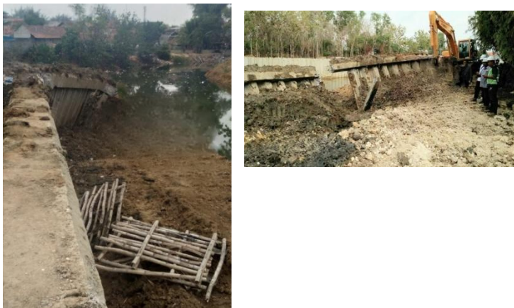
Gambar 3. Robohnya Tiang Pancang Sungai Kemoning
