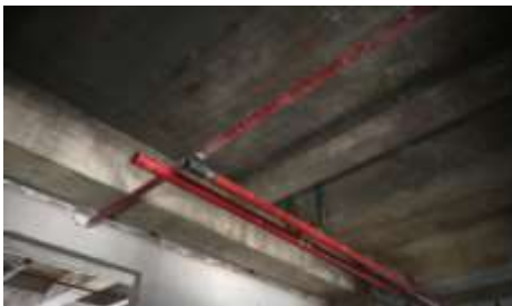
Gambar 1. Pipa Tegak dan Pipa Mendatar Sumber: Dokumentasi Pribadi
