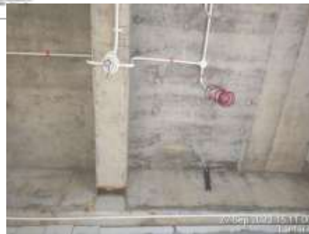
Gambar 8. Pipa Conduit Fire Alarm Sumber: Dokumentasi Pribadi
